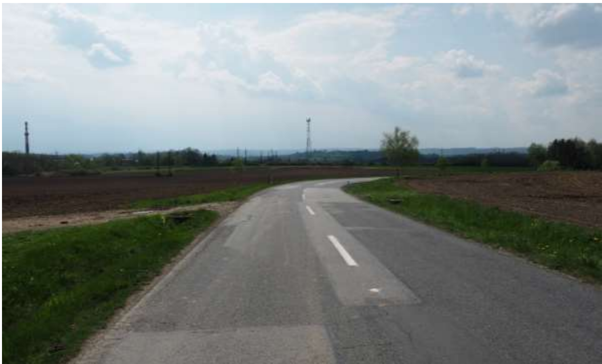
Úsek silnice II/315 u obce Sruby
