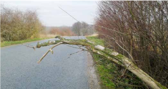
Spadlá větev zasahující do silnice při výjezdu ze zatáčky
