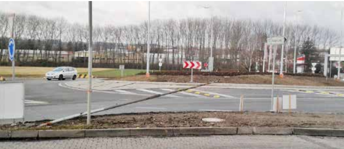
Sražený sloup u nově vybudovaného kruhového objezdu ve Vysokém Mýtě
