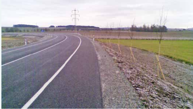
Nevhodná výsadba stromů v polovině násypového svahu
