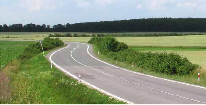
Jednoznačnost trasy komunikace vymezená VDZ a směrovými sloupky
